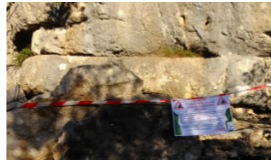
▲ Secteur provisoirement condamné en raison d'un éboulement signalé par un grimpeur.
